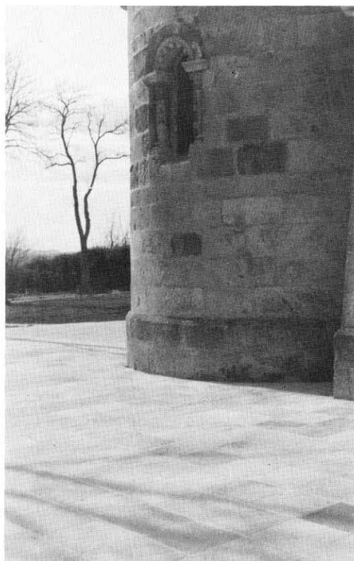
El enlosado al rededor de los ábsides de la Basílica favorecerá la conservación y estabilidad del edificio al dificultar la filtración de humedad a los cimientos. La obra se ha realizado con piedra procedente de Yugoslavia curiosamente autodecorada.
